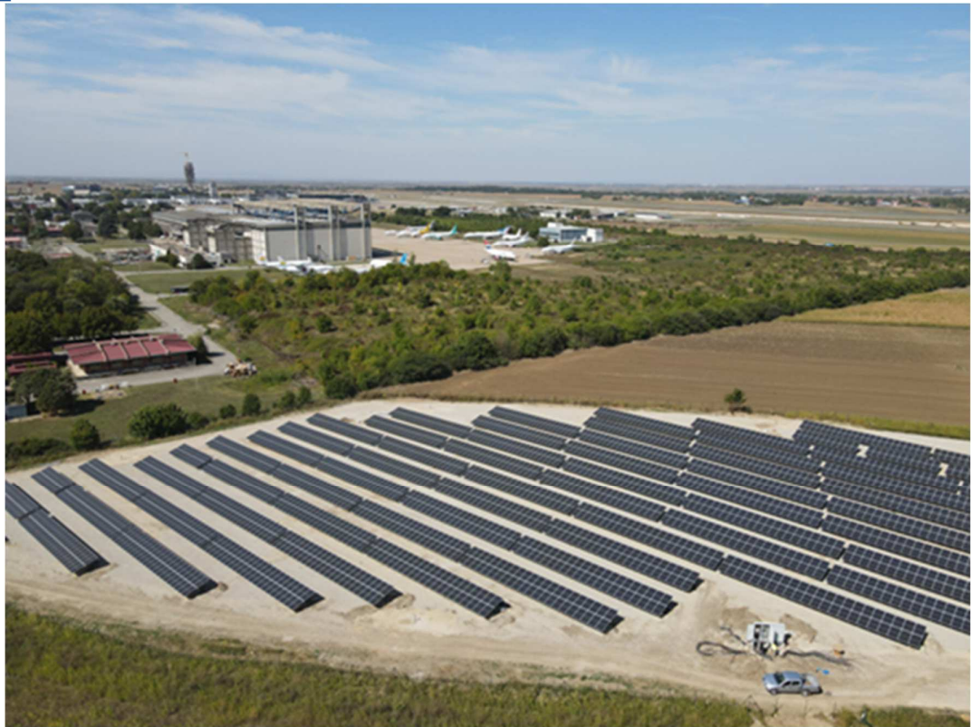
Слика 7 Фотонапонско постројење
